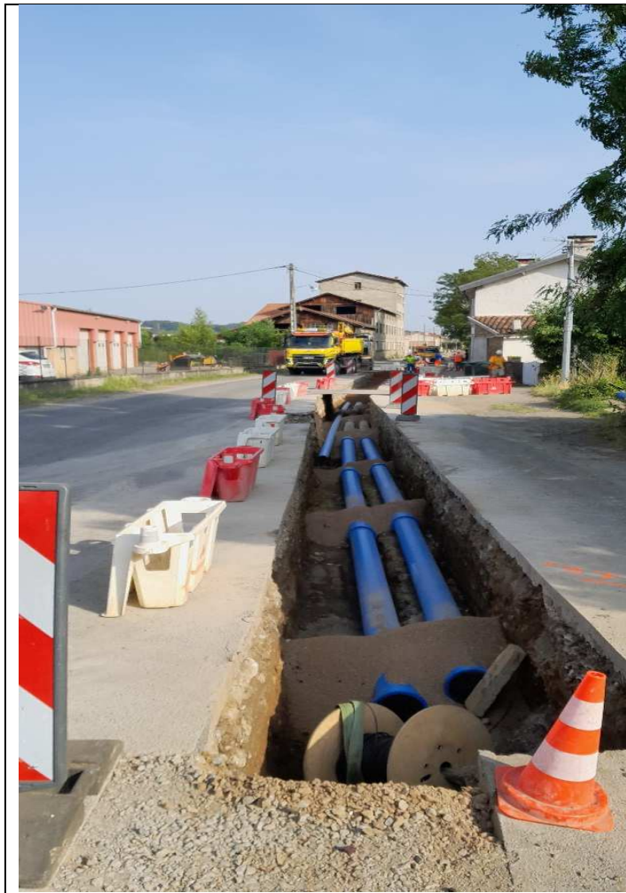
Pose de réseaux d'eau potable rue des évadés de France à Saint Girons
